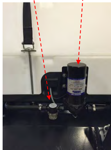
Vattenfilter och vattenpump
